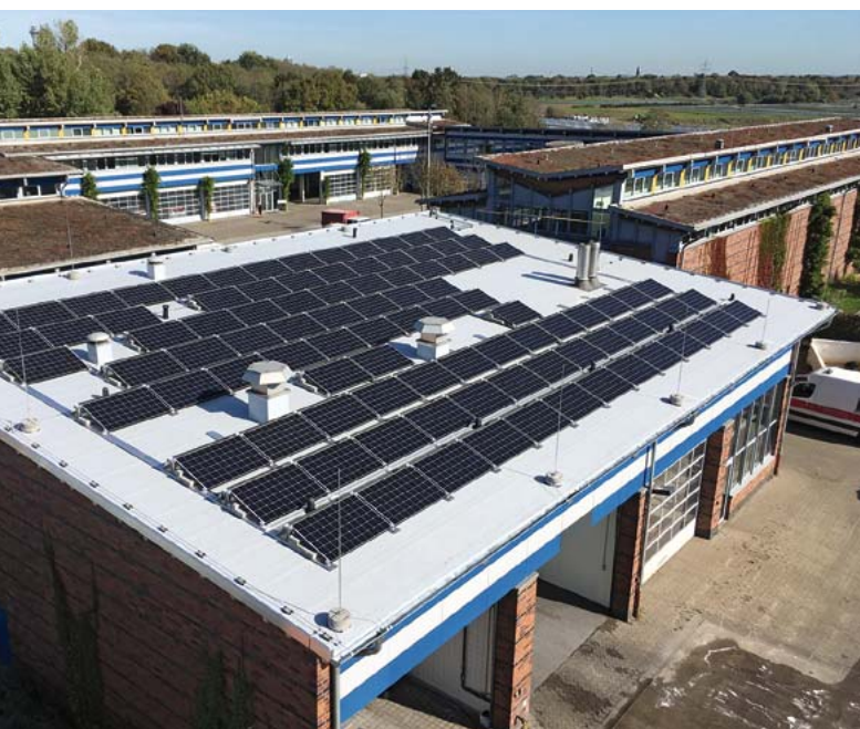
Der Düsseldorfer Stadtentwässerungsbetrieb hat im Jahr 2018 die erste städtische Photovoltaikanlage mit direkter Nutzung des erzeugten Stroms in Betrieb genommen. Foto: © Landeshauptstadt Düsseldorf, SEBD
