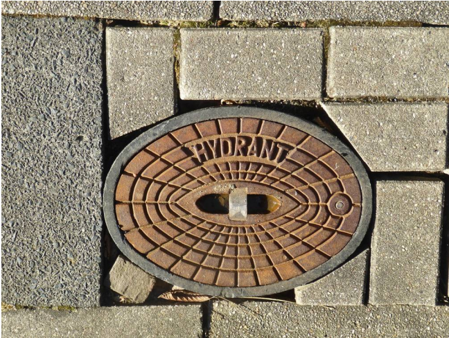
Bild 14: Hydranten im Gehweg benötigt die Feuerwehr.
